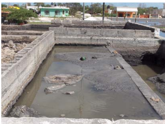
“Trampas de grasa” en las lagunas de oxidación
