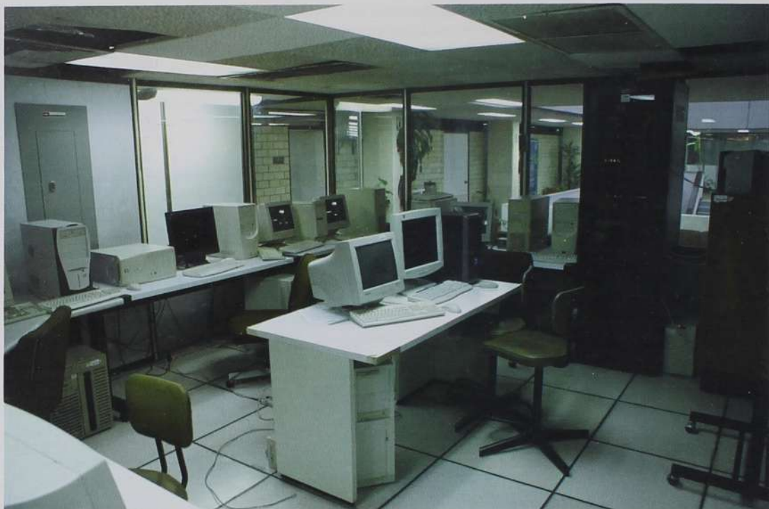
Figura 4. Sala donde se alojan los servidores de red del Departamento de Computación.
